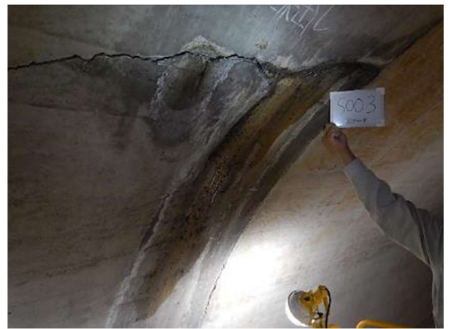
アーチ部の漏水
