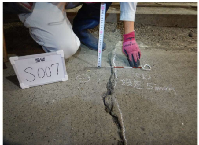
車道部舗装の段差
