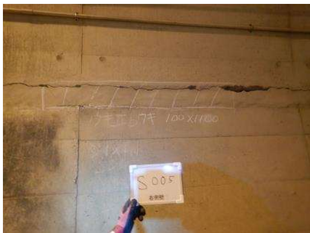
材質劣化による浮き・剥離
