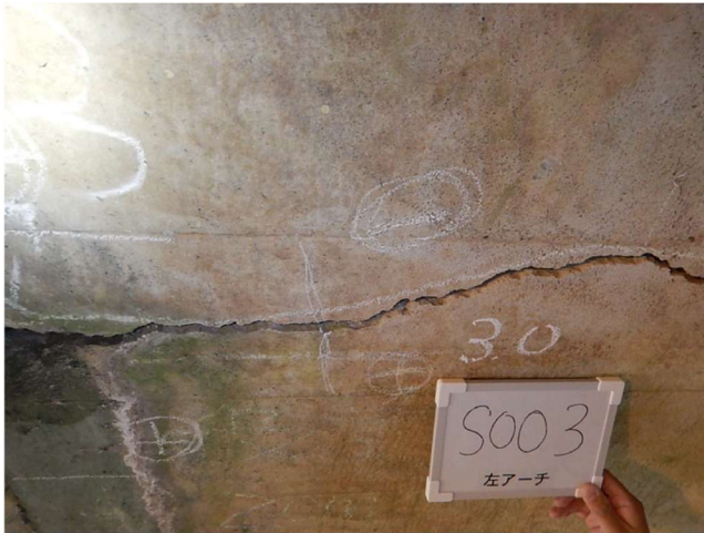
外力による縦断ひび割れ
