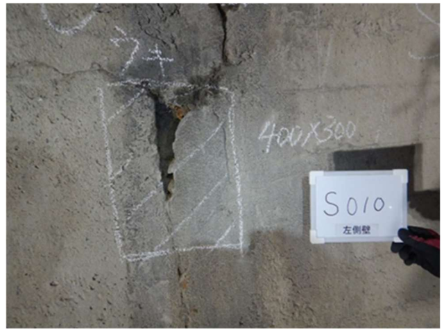
材質劣化による浮き・剥離
