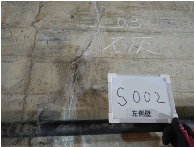
側壁部のひび割れ
