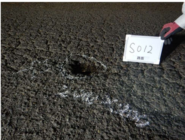
材質劣化による路面の欠損
