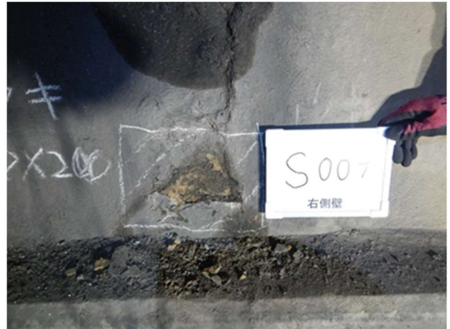
材質劣化による浮き・剝離
