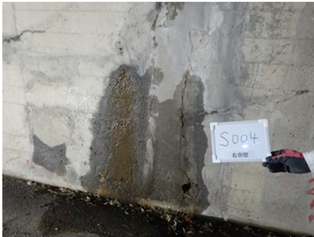
側壁部からの漏水
