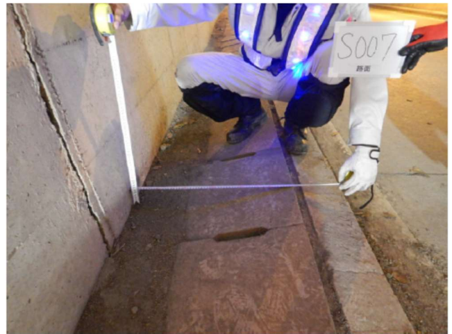
監査歩廊の縁石の損壊と傾斜
