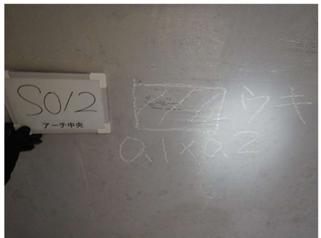
対策済箇所の浮き
