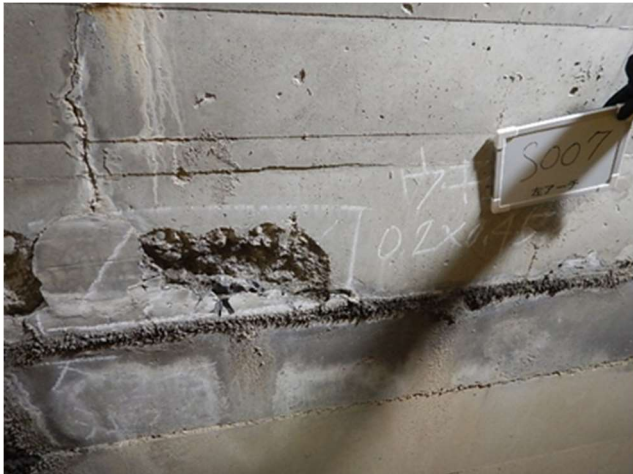
材質劣化によるひび割れ
