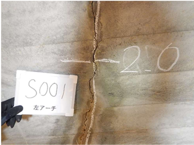
起点側坑口部 (S001) の横断ひび割れ
