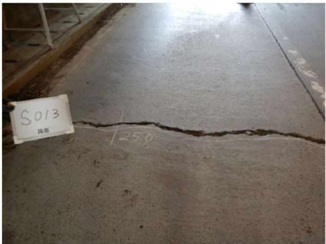
車道部舗装の横断ひび割れ
