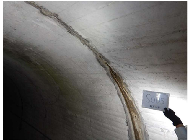
目地部からの漏水
