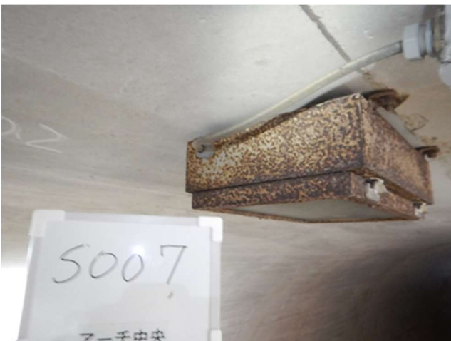
照明施設の腐食
