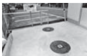
災害用 マンホールトイレ
