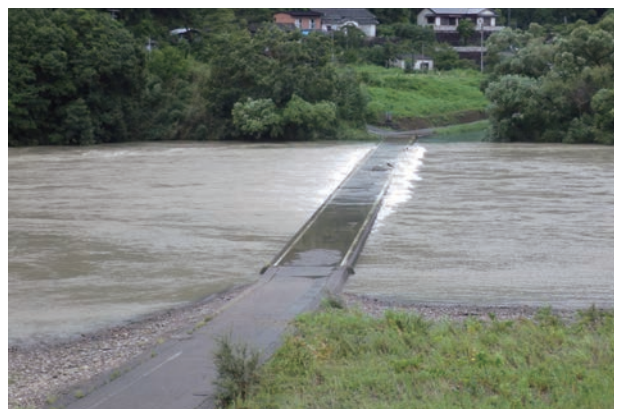
増水時には沈下
