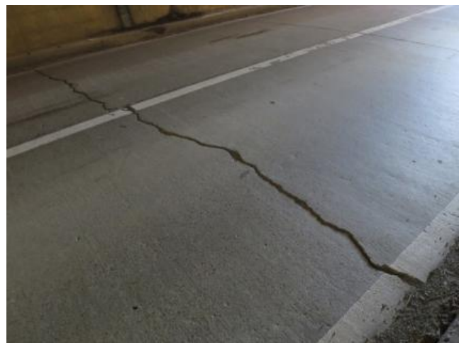
車道舗装段差を有するひび割れ
