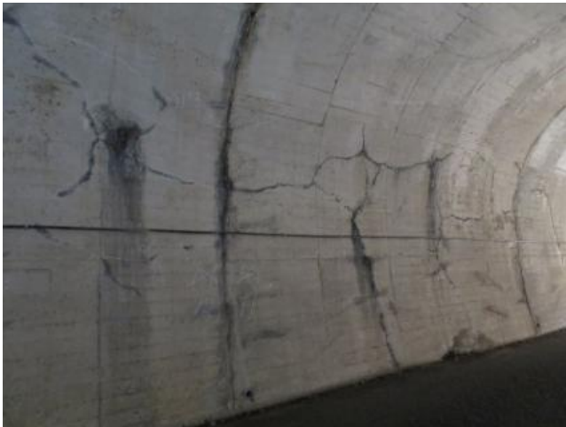
外力によることが推定される連続する縦断ひび割れ
