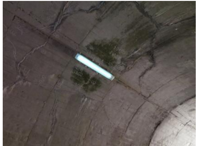
ひび割れからの漏水
