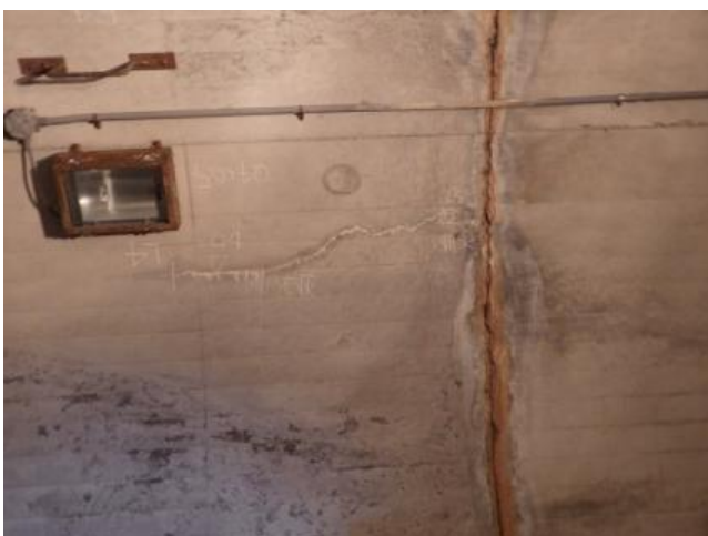
横断目地部からの漏水と照明施設の腐食
