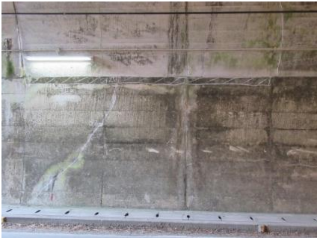
上下半の打ち継ぎ目（せめ部）の浮き剥離
