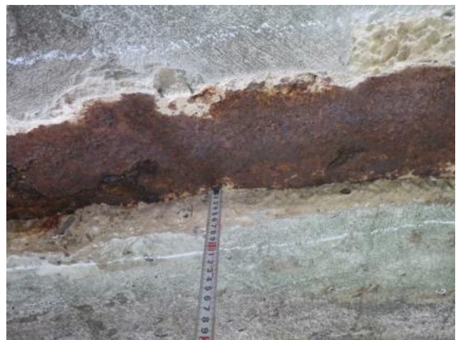
巻厚不足による鋼製支保工の腐食
