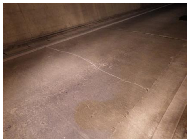
路面の軽微なひび割れ
