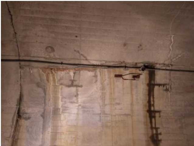
天端付近の縦断ひび割れ（温度収縮）と漏水
