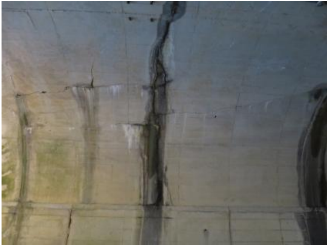
外力によることが推定される開口縦断ひび割れ
