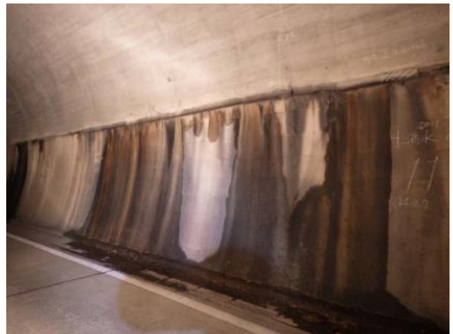
上半打ち継ぎ目（せめ部）からの漏水
