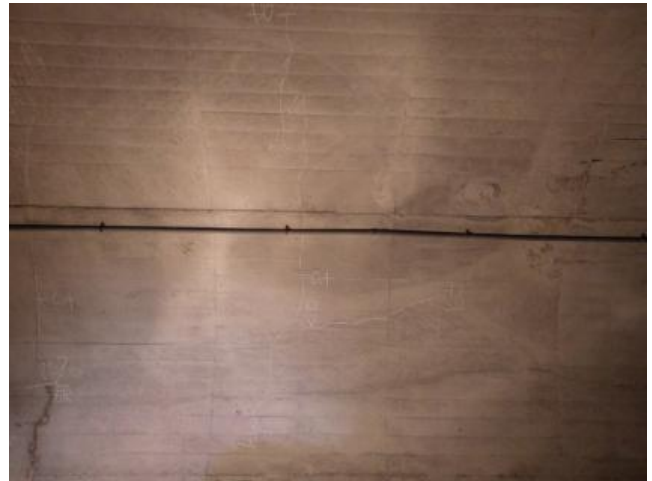
アーチの軽微なひび割れ（温度収縮）
