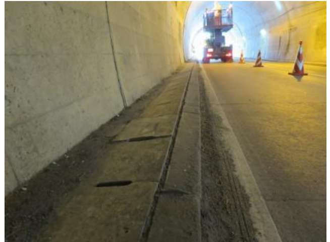
監査路（側壁下端部）の変形
