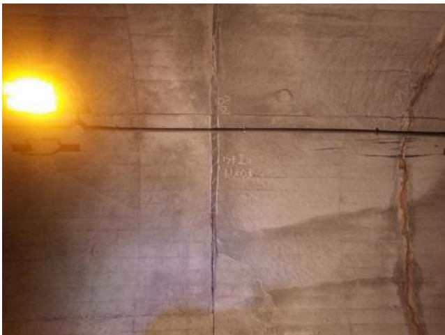
横断目地沿いの浮き剥離
