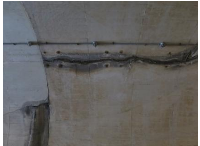
ひび割れからの漏水
