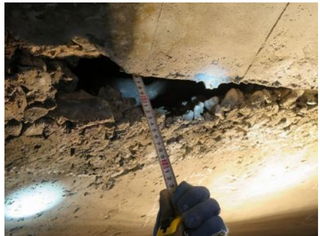
巻厚不足と目地沿いの材質不良（ジャンカ）
