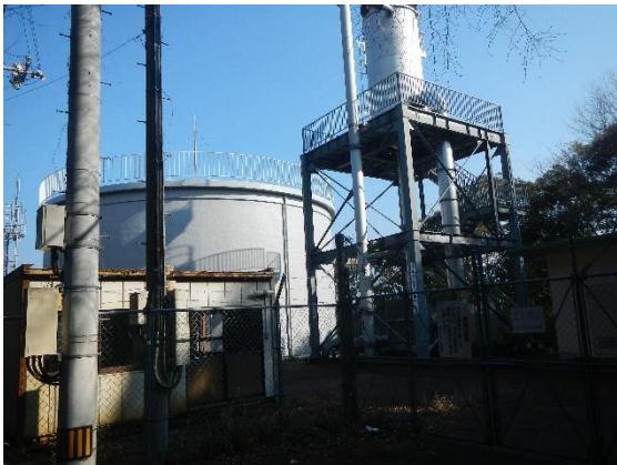
図表 2-13 具同配水池及びばっ気塔
