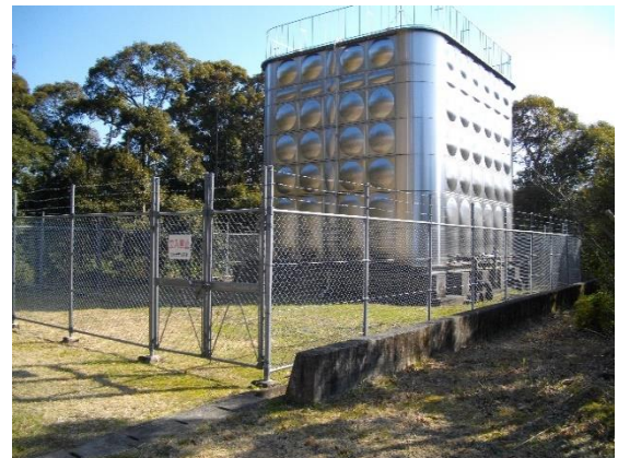
図表 2-14 西部統合簡易水道配水池
