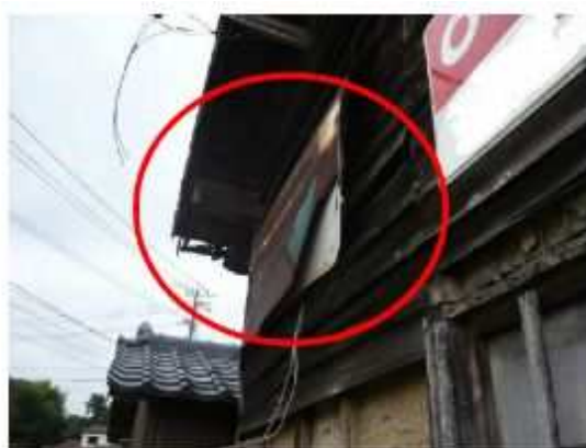
鉄製看板の落下の危険性
