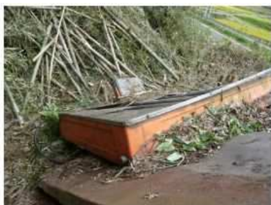
屋上給湯設備の落下
