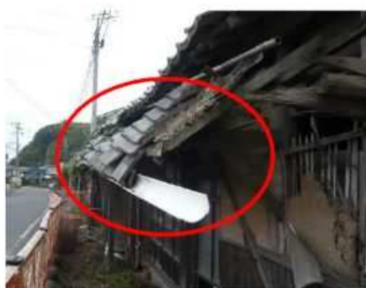
屋根、軒が垂れ下がっている
