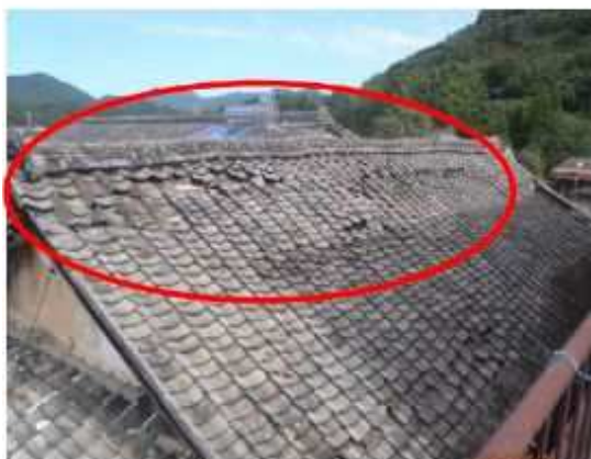
瓦が周囲に飛散する危険がある
