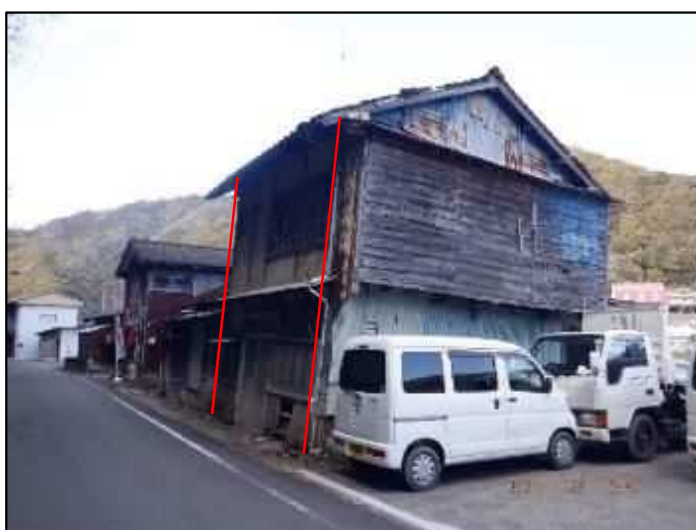
建物が傾斜し倒壊の危険
