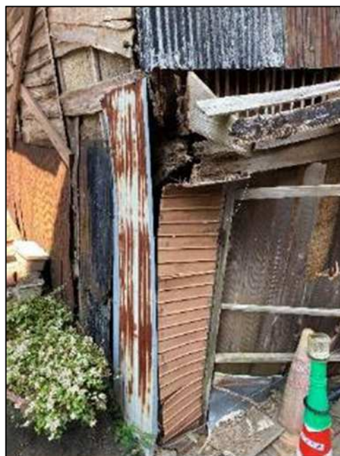
柱とはりにずれが発生している
