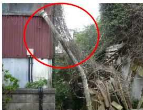
臭気筒が隣地へ倒れている
