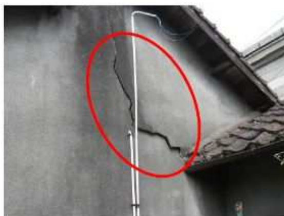
外装材にひび割れがある
