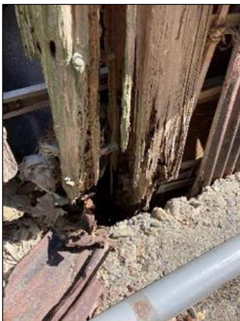
柱脚が腐朽し欠損している
