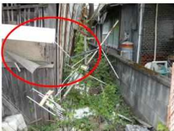
外壁材が剥がれている
