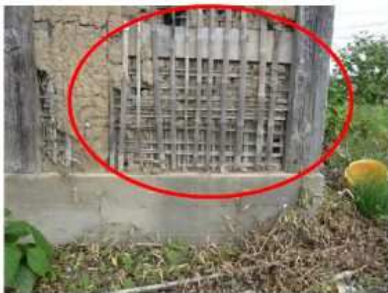
外壁材が剥がれて土壁が露出
