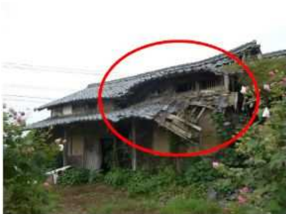
屋根が一部落下している
