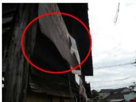
鉄製看板落下の危険性
