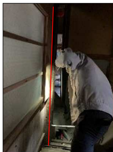
柱が傾斜している
