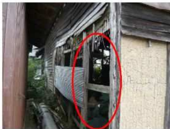
外壁材が無くなっている
