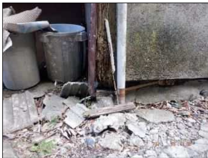
基礎と土台にずれが発生している
