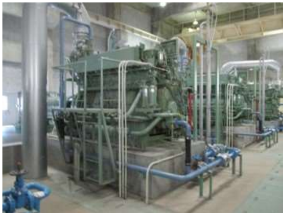
図表 2-14 八反原排水機場 3号エンジン
