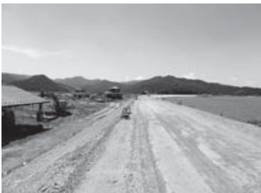
右岸堤防決壊 上流4～8km(復旧中)
