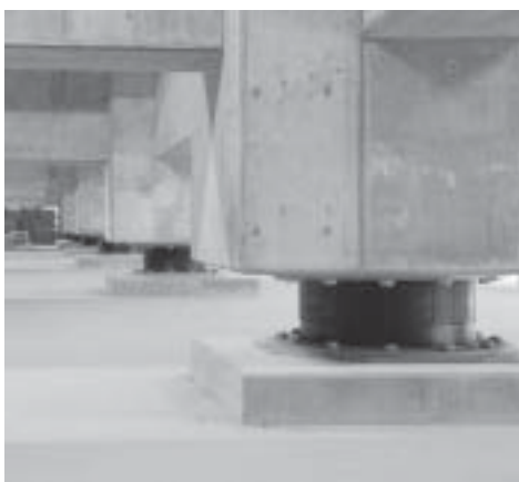
免震装置を付けた市庁舎支柱
