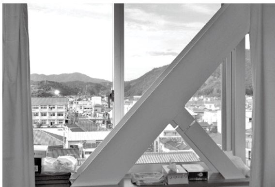
病棟耐震ブレース
