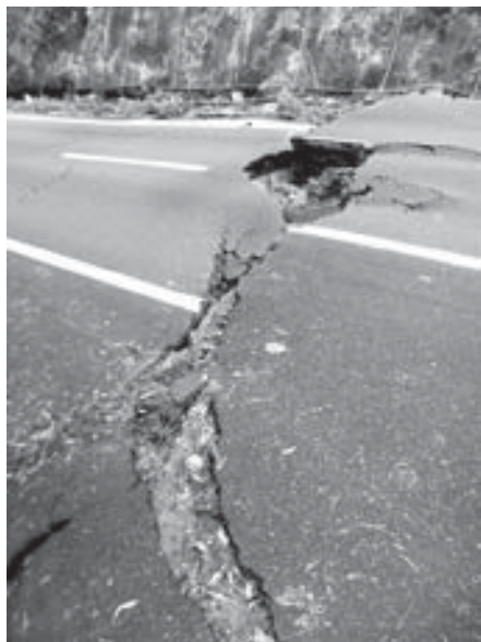
国道439号 伊才原地区の亀裂箇所
