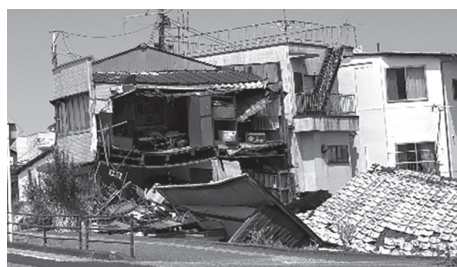
家屋倒壊写真 (令和8年熊本地震災害派遣職員による撮影)
