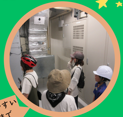
機械室を見学
