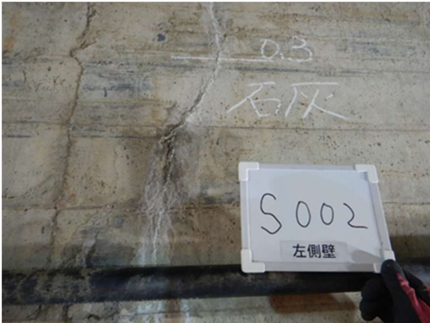
側壁部のひび割れ
