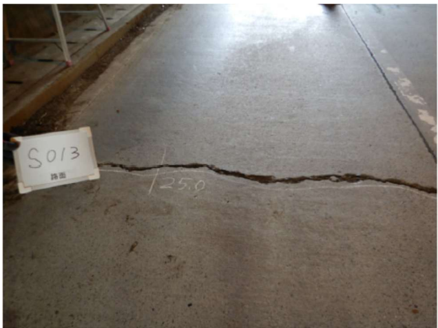
車道部舗装の横断ひび割れ
