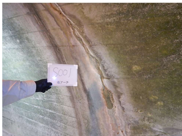
起点側坑口部（S001）の横断ひび割れ
