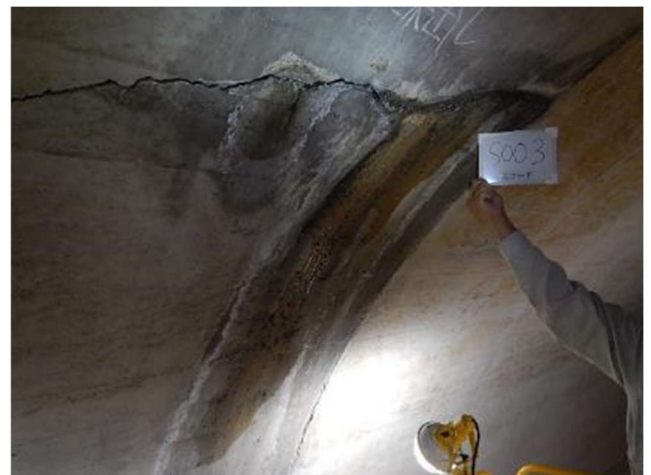
アーチ部の漏水
