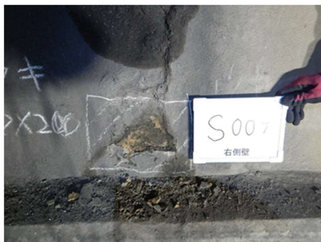
材質劣化による浮き・剝離
