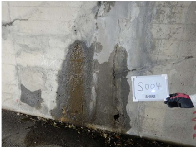
側壁部からの漏水
