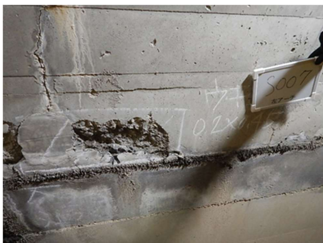
材質劣化によるひび割れ
