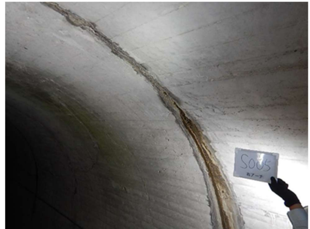
目地部からの漏水
