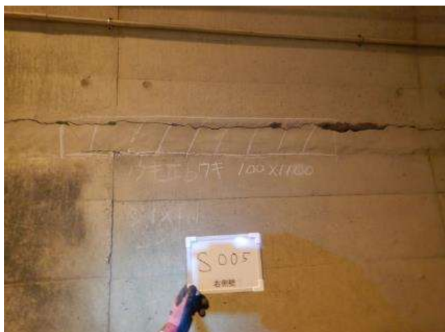
材質劣化による浮き・剥離
