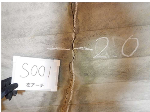
起点側坑口部（S001）の横断ひび割れ
