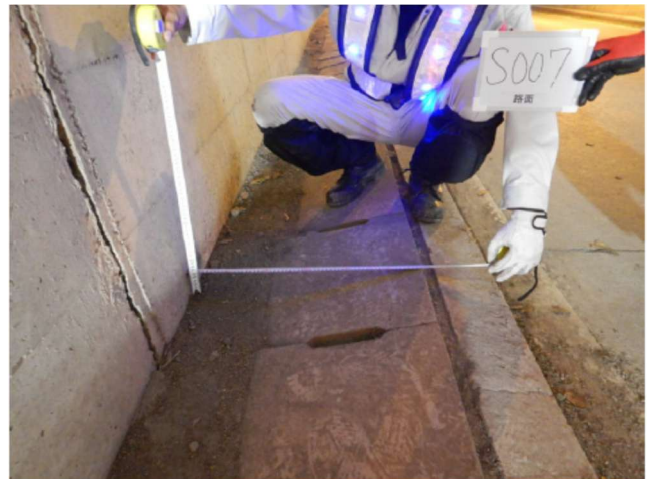
監査歩廊の縁石の損壊と傾斜
