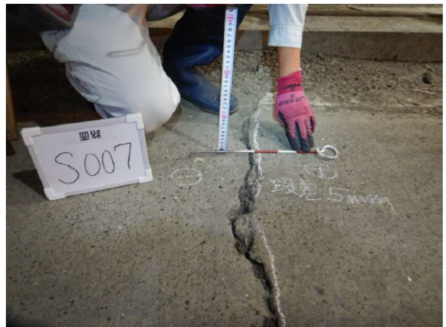
車道部舗装の段差
