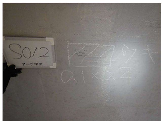
対策済箇所の浮き
