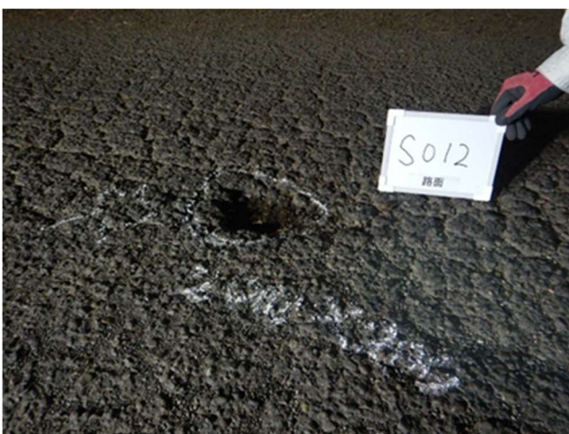
材質劣化による路面の欠損
