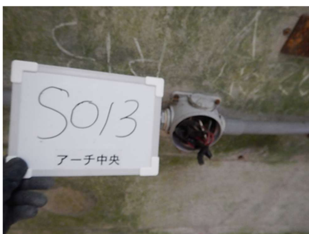
照明施設のキャップ脱落
