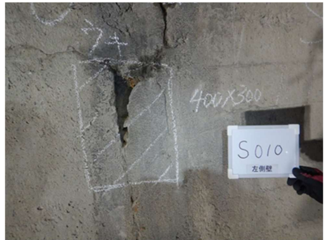
材質劣化による浮き・剥離
