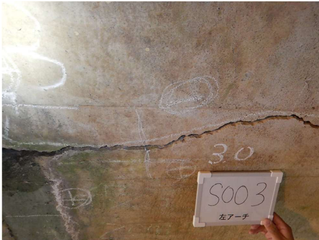
外力による縦断ひび割れ
