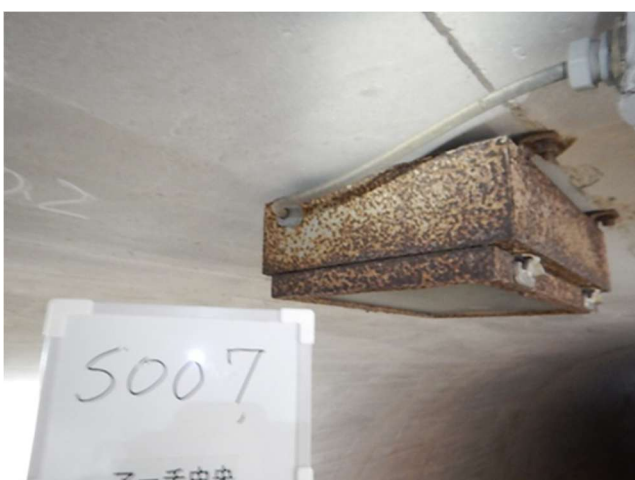
照明施設の腐食
