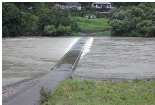
増水時には沈下
