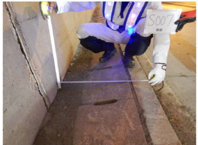
監査歩廊の縁石の損壊と傾斜
