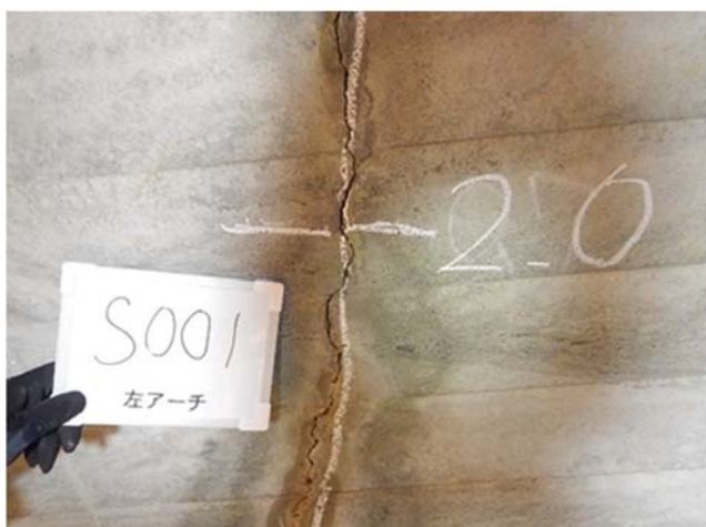
起点側坑口部（S001）の横断ひび割れ
