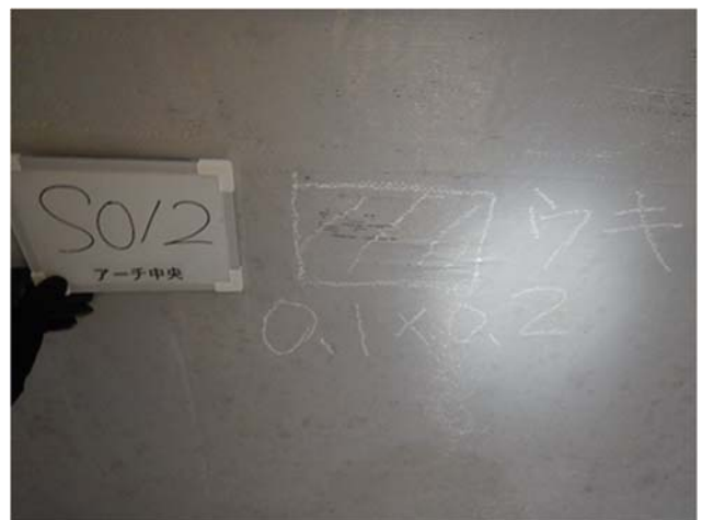
対策済箇所の浮き
