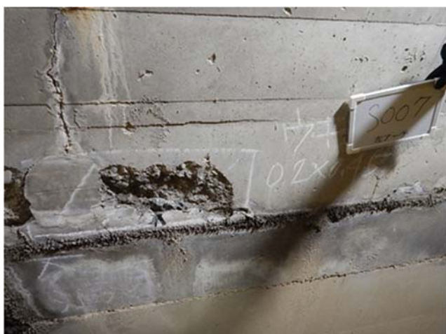
材質劣化によるひび割れ
