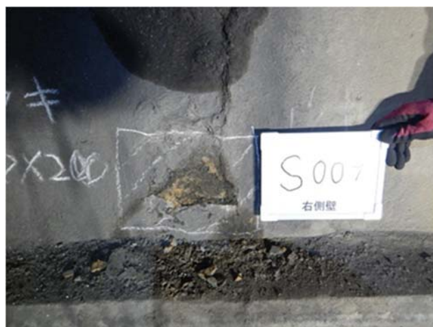
材質劣化による浮き・剝離
