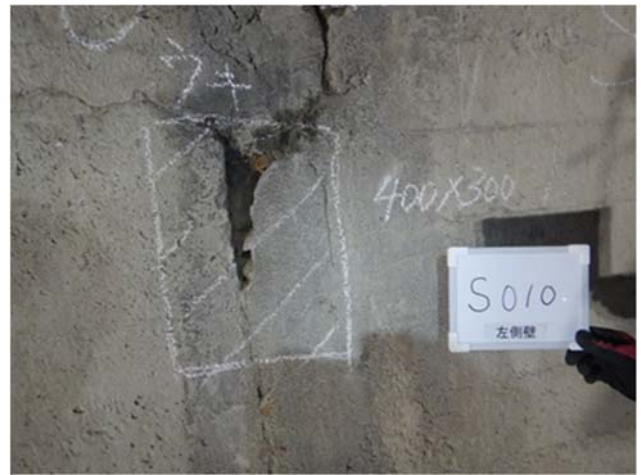
材質劣化による浮き・剥離
