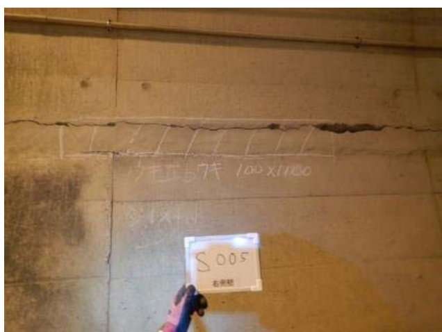
材質劣化による浮き・剥離
