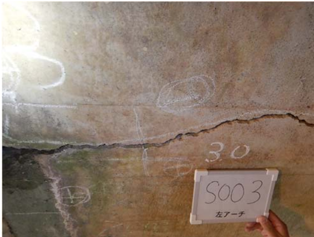
外力による縦断ひび割れ
