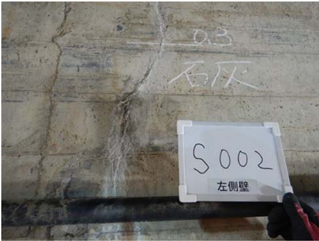
側壁部のひび割れ
