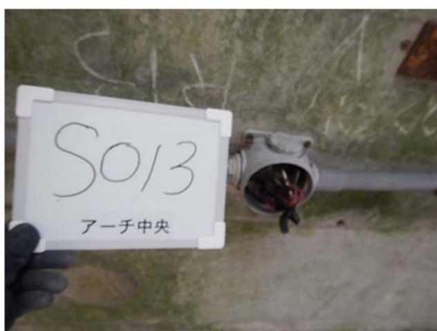
照明施設のキャップ脱落
