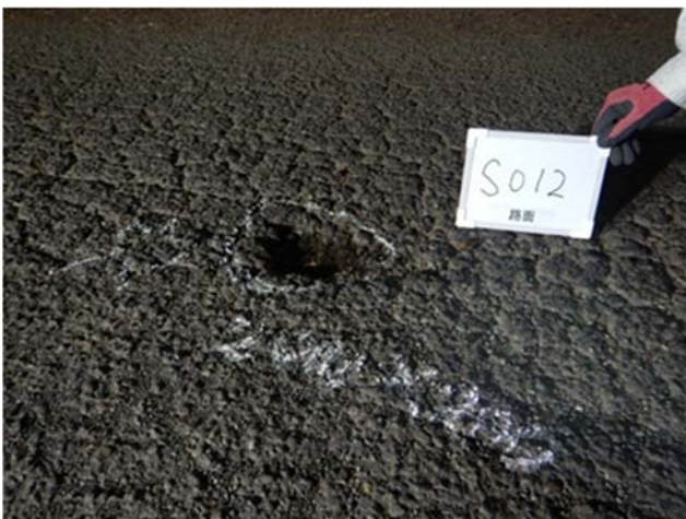
材質劣化による路面の欠損
