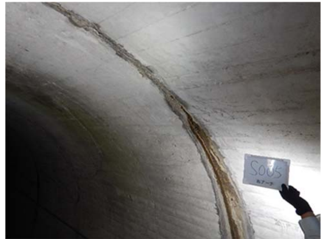
目地部からの漏水
