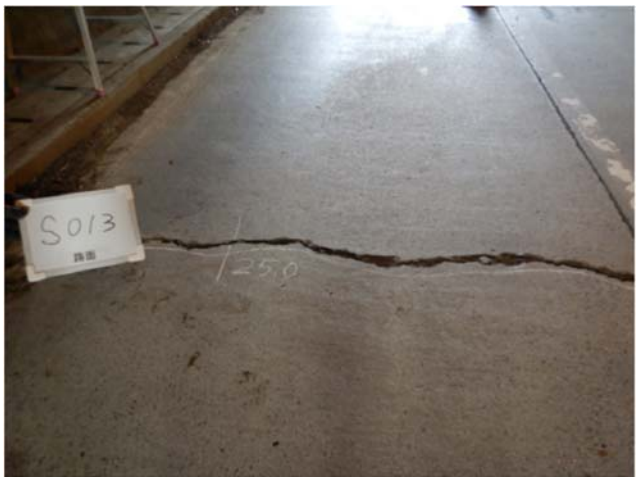
車道部舗装の横断ひび割れ
