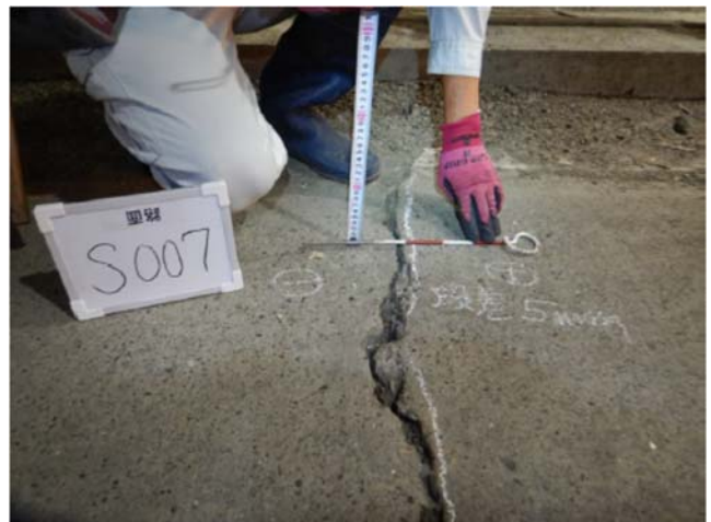
車道部舗装の段差
