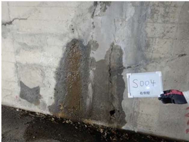
側壁部からの漏水
