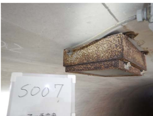
照明施設の腐食
