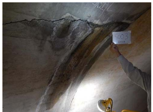
アーチ部の漏水
